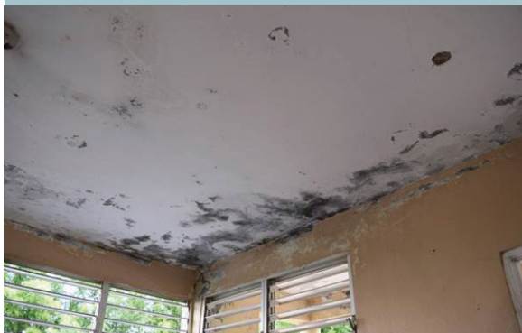
Humedades destacamento Hermanas Mirabal, SFM
