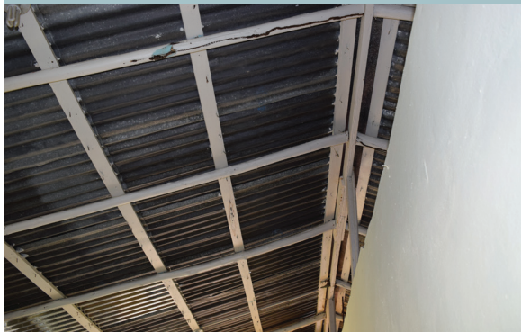
Techo de zinc destacamento Maimón, Puerto Plata
