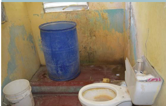
Baño destacamento Zona Franca, La Vega
