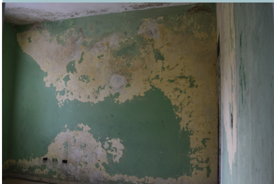
Humedades en destacamento Imbert, Puerto Plata
